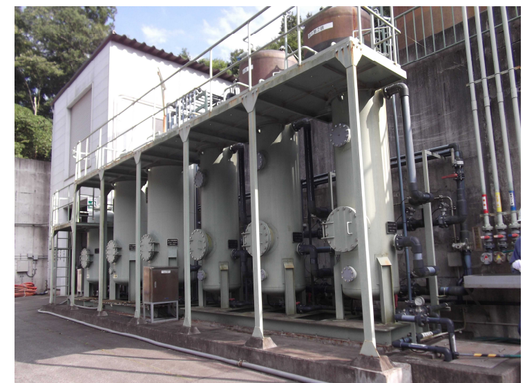
（参考）ゼオライト吸着塔 （特定廃棄物埋立処分施設にて2018年9月撮影）
